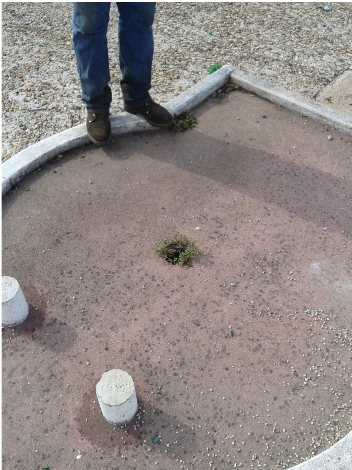
Ervas e pedras demonstram a falta de cuidado de quem deveria zelar pelo espaço
