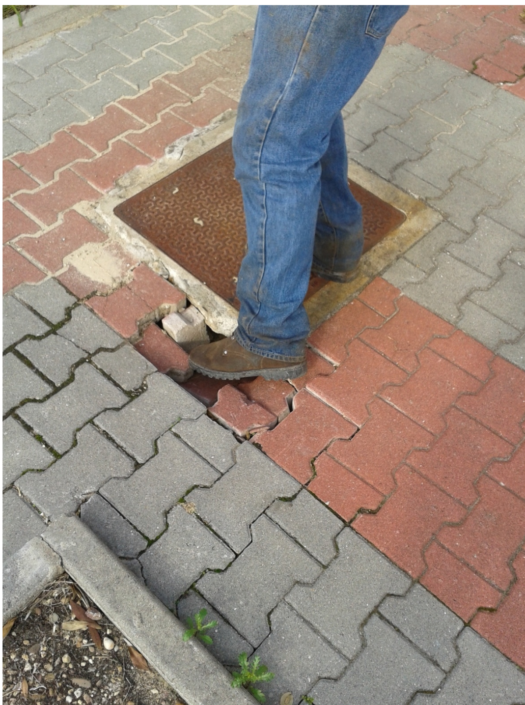
Buracos no pavimento. A foto mostra o pé de um adulto
